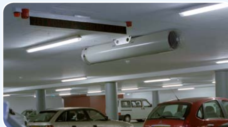
Parkeergarage met CO/LPG detectie
