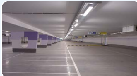
Parkeergarage met Mütec sensorkabeldetectie
